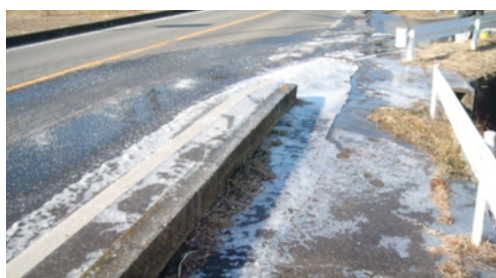
漏水による路面凍結
