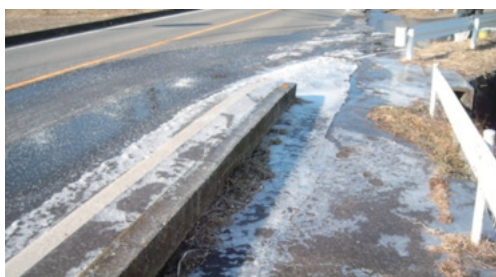
漏水による路面凍結
