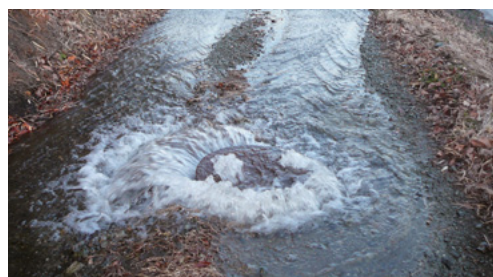
空気弁からの漏水
