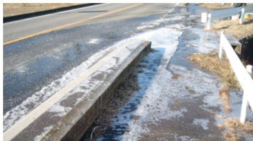
漏水による路面凍結
