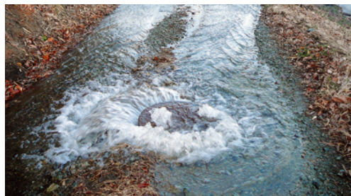
空気弁からの漏水
