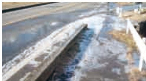
漏水による路面凍結
