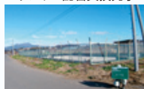
フェンス補修前
