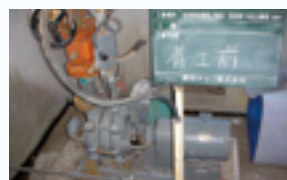
ポンプ・配管交換前
