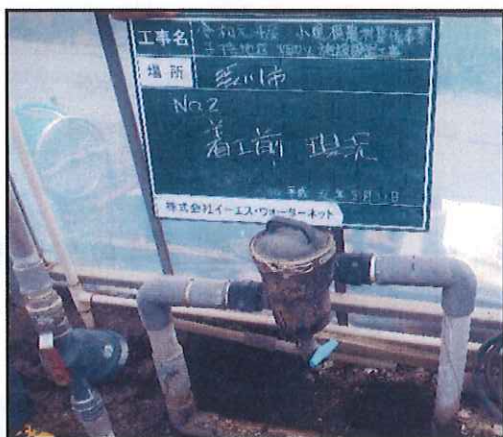
渋川市内イチゴハウス 除塵フィルター交換前
