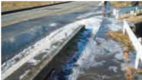
漏水による路面凍結
