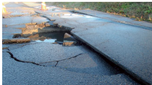
空気弁からの漏水
