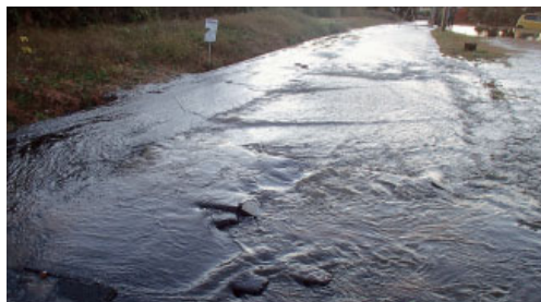
漏水による路面凍結
