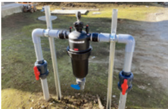
除塵機(フィルター)の設置状況
