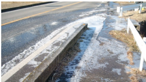
漏水による路面凍結
