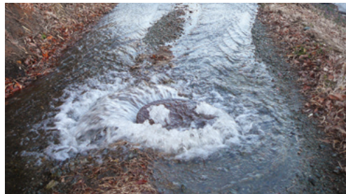
空気弁からの漏水
