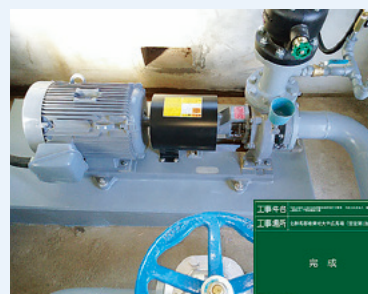
ポンプ・モーター更新
