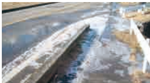
漏水による路面凍結
