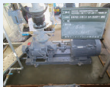
ポンプ・モーター更新
