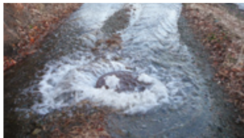
空気弁からの漏水
