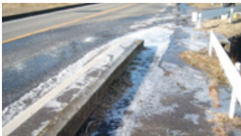
漏水による路面凍結
