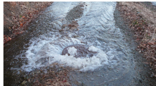
空気弁からの漏水
