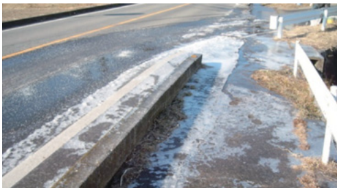
漏水による路面凍結
