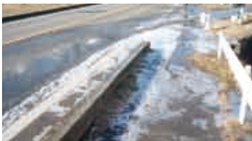
漏水による路面凍結
