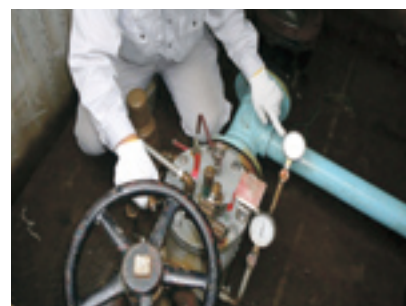
減圧弁の作動調整
