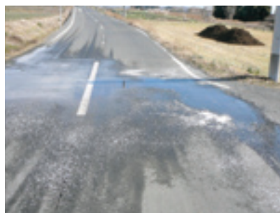
道路からの漏水による路面凍結状況
