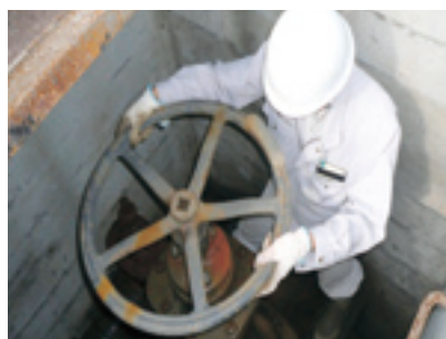
パイプラインのバルブ操作状況
