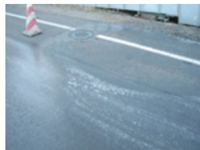
空気弁からの漏水による路面凍結状況
