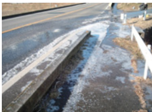
漏水による路面凍結
